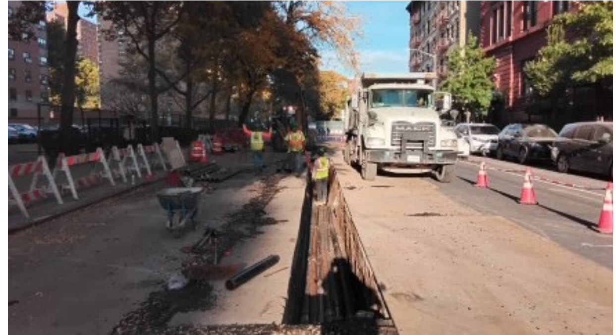
Electrical Conduit Installation
