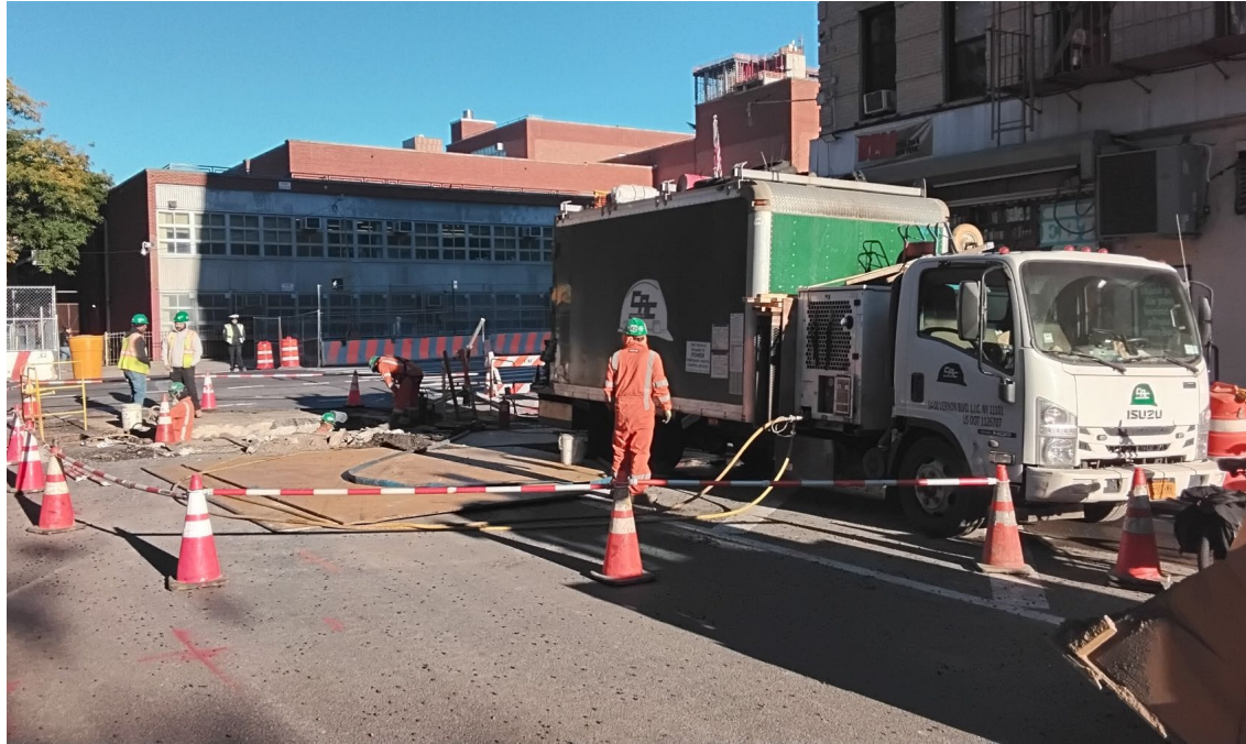
Electrical Conduit Installation
